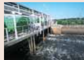
排水処理施設
