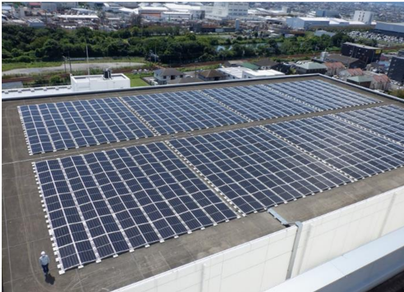
静岡工場：生薬倉庫棟屋上に太陽光パネルを設置し、年間CO 2 排出量を160tの削減
