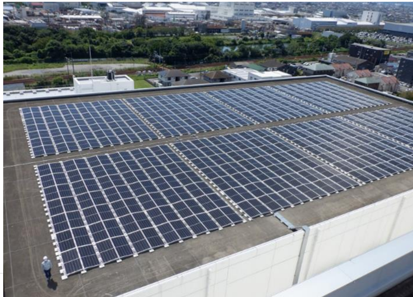
静岡工場：生薬倉庫棟屋上に太陽光パネルを設置し、年間CO 2 排出量を160tの削減
