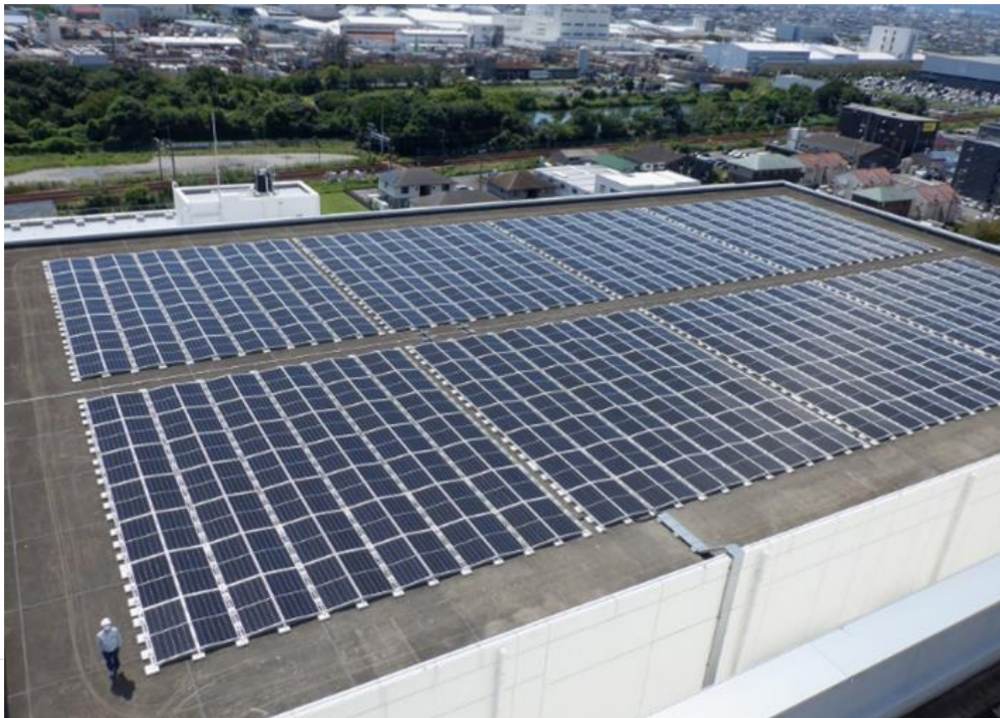
静岡工場：生薬倉庫棟屋上に太陽光パネルを設置し、年間CO 2 排出量を160tの削減
