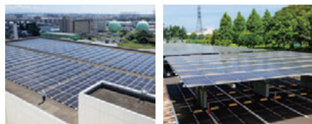
静岡工場のソーラーパネル 茨城工場のソーラーカーポート
