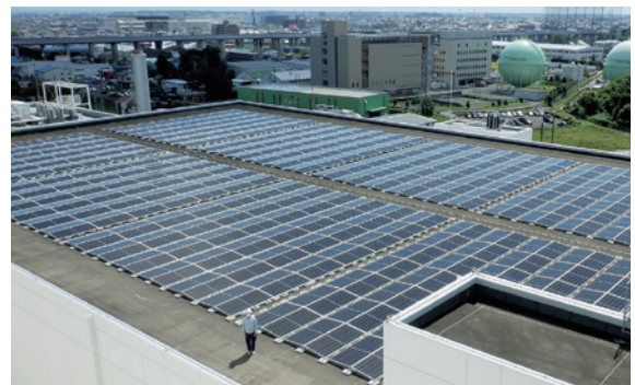
2021年9月 在静冈工厂生药库房安装的光伏发电板
