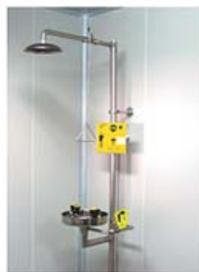
▲薬品事故に備えた緊急シャワー
