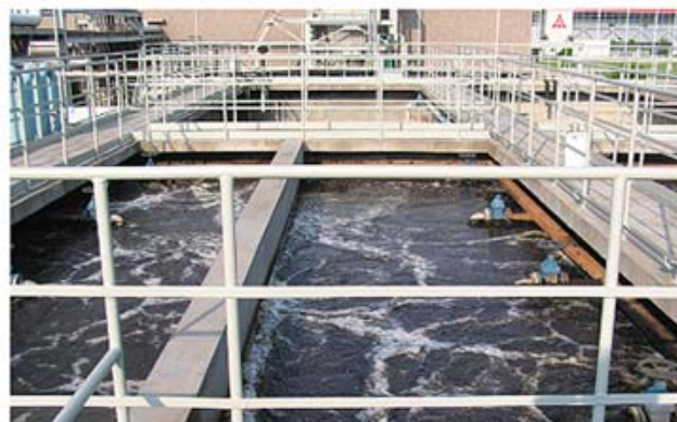
▲排水処理施設（上海津村）
