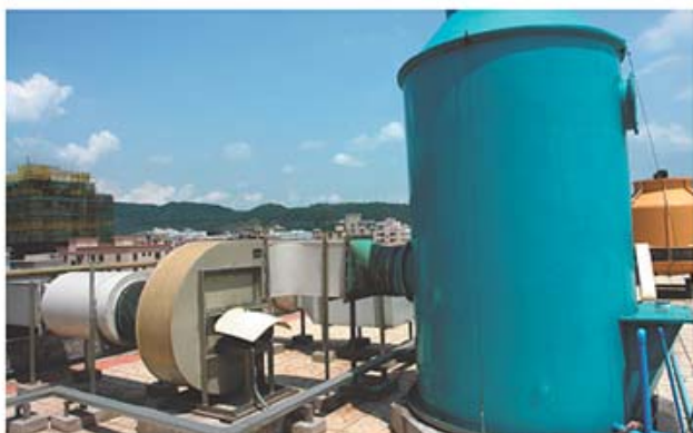
▲ウォータースクラバーと光触媒による排気の浄化（深圳津村）
