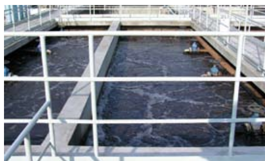
排水処理施設(上海津村)
